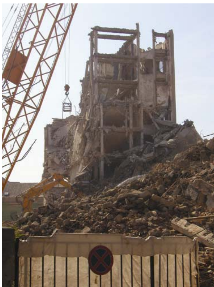
Fig. 7 a. Ministerul Industriei constructoare de mașini în timpul demolărilor văzut de pe Str. Gen. Manu (aprilie 2007), foto ASI.
