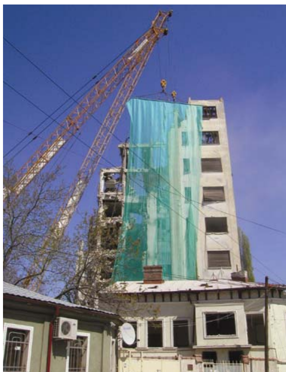
Fig. 7 c. Ministerul Industriei constructoare de mașini în timpul demolărilor văzut dinspre Str. Mihail Moxa (aprilie 2007), foto ASI.
